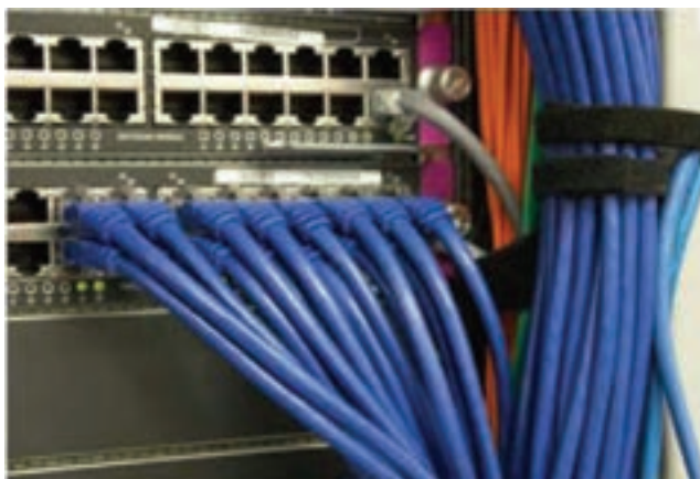
شکل ۲۵-۴- اتصال کابل‌ها به پیچ پانل
